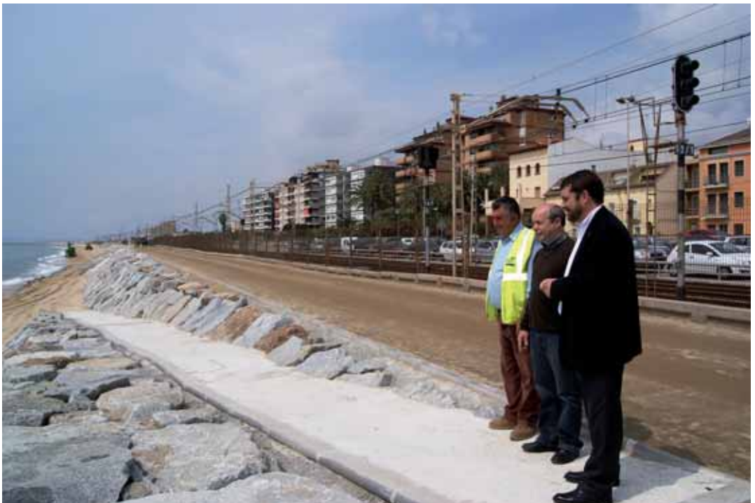
L'alcalde i el regidor d'Urbanisme amb el cap d'obra en una de les rampes d'accés a la platja
