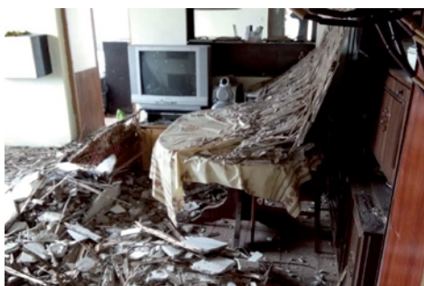
La pluja també va carregar amb força contra les cases d'alguns particulars, desplomant sostres o inundant baixos.
