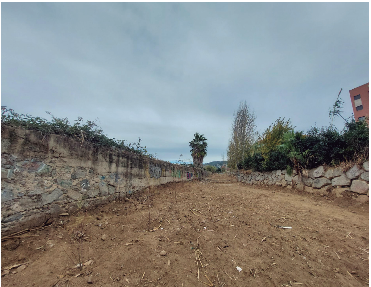
Aspecte de la Riera de Vilassar, després de l'actuació
