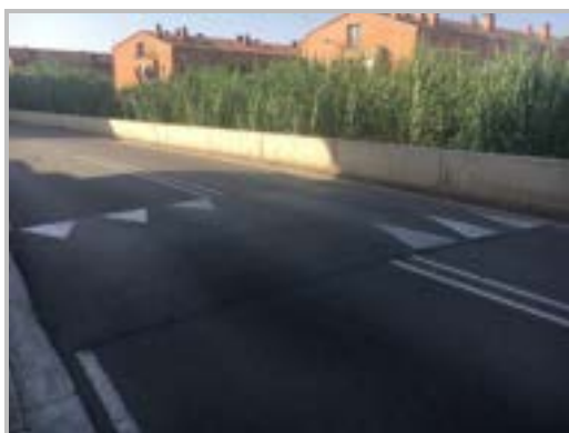
Imatge 27. Ressalt reductor de velocitat a la ronda Vilassar. Font: AIM, elaboració pròpia.
