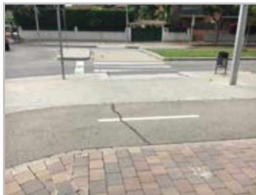
Imatge 22. Mal estat de la vorera bici. Font: AIM, elaboració pròpia.
