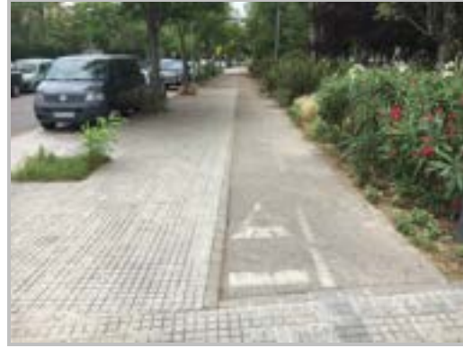
Imatge 18. Senyalització horitzontal semi esborrada. Font: AIM, elaboració pròpia.
